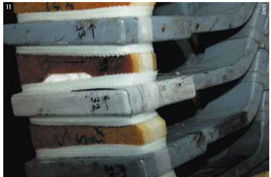
Bild 11 Installierter faseroptischer Schwingungssensor für tangentiale Messrichtung
